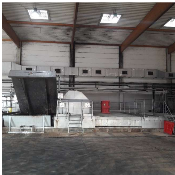
Gaine d'aspiration à l'intérieur du hall
